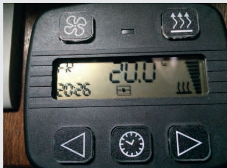
Die Heizung kann über das Panel auf verschiedenste Weisen programmiert werden
